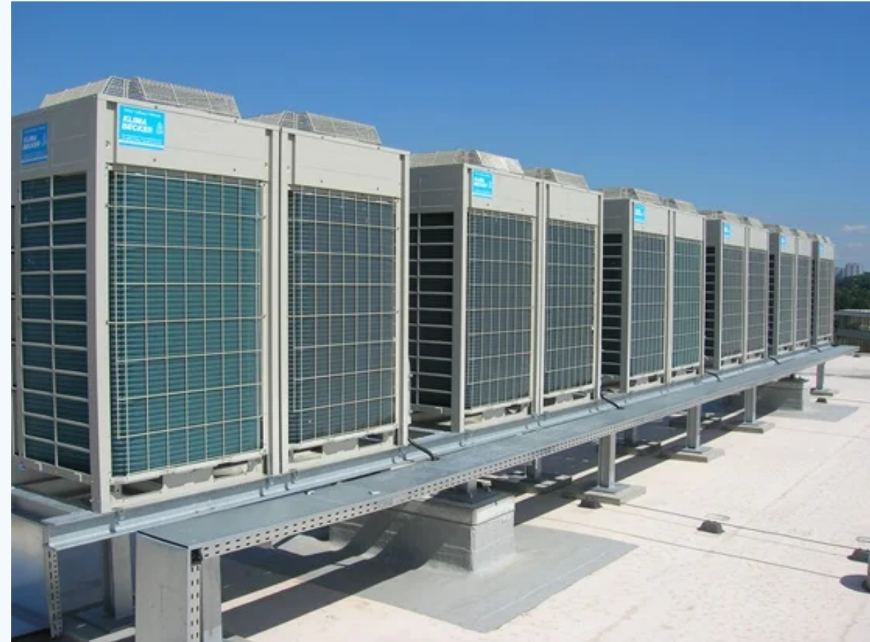
Photo 10 : Unité extérieure à source d'air VRF
